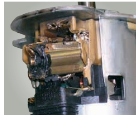
Schadensbild: Schmelzspuren am Elektromotor oder an den elektrischen Kontakten
