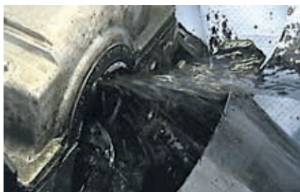
Achtung: Bei einer einwandfreien Schmierölaufuhr können hier 30–60 Liter pro Stunde fließen.
